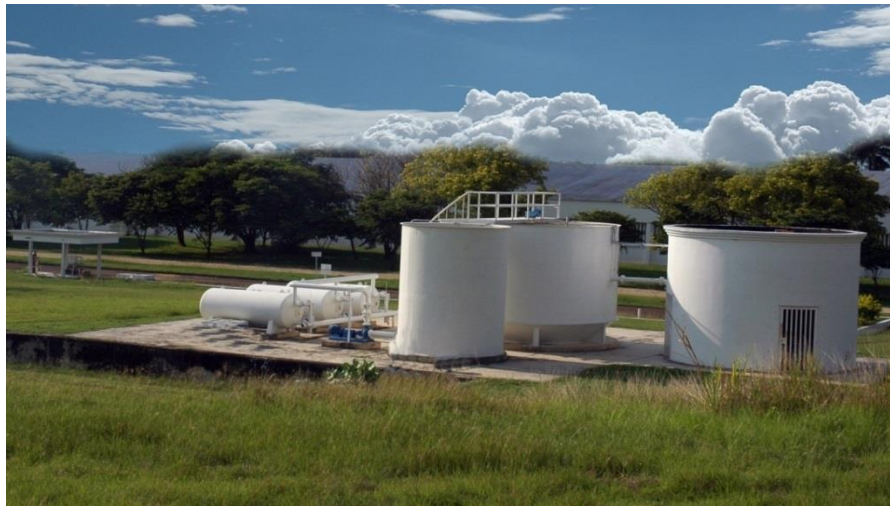
Figura 7. Planta de tratamiento de Agua.
